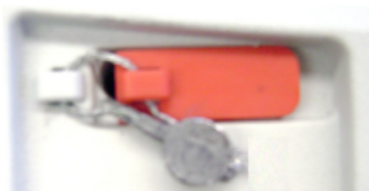
Блокировка включена и опломбирована проволочной пломбой
